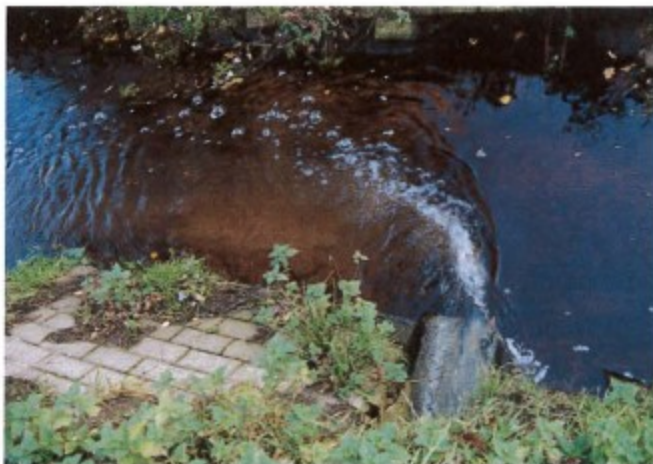
Abb. 2.4.4-1: Abwasser-Einleitung der Fa. A&L Produktions GmbH zwischen Be1 und Be2 (s. Abb. 2.5-1)
