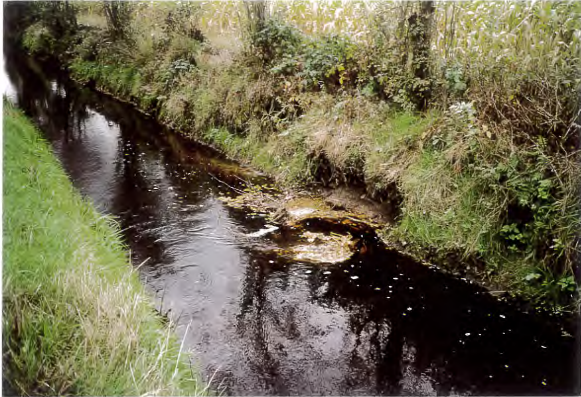
Foto 22: Ufererosion bei Stat. 4 + 300, Blick in Fließrichtung
