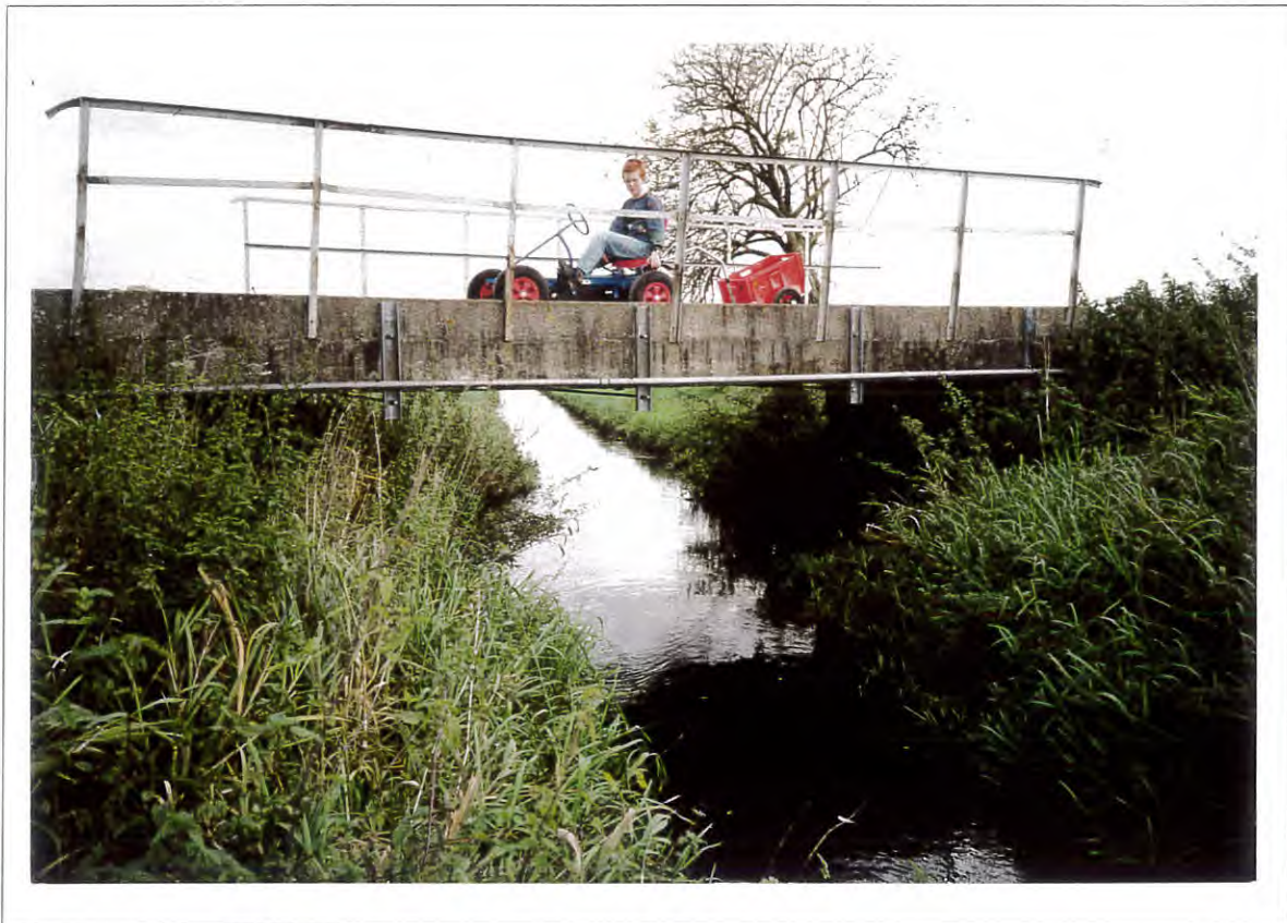
Foto 6: Brücke im Bereich Dustmühle, Blick in Fließrichtung. Durchlaßbauwerk Nr. 1, Stat. 0 + 750 (geringe Beeinträchtigung).
