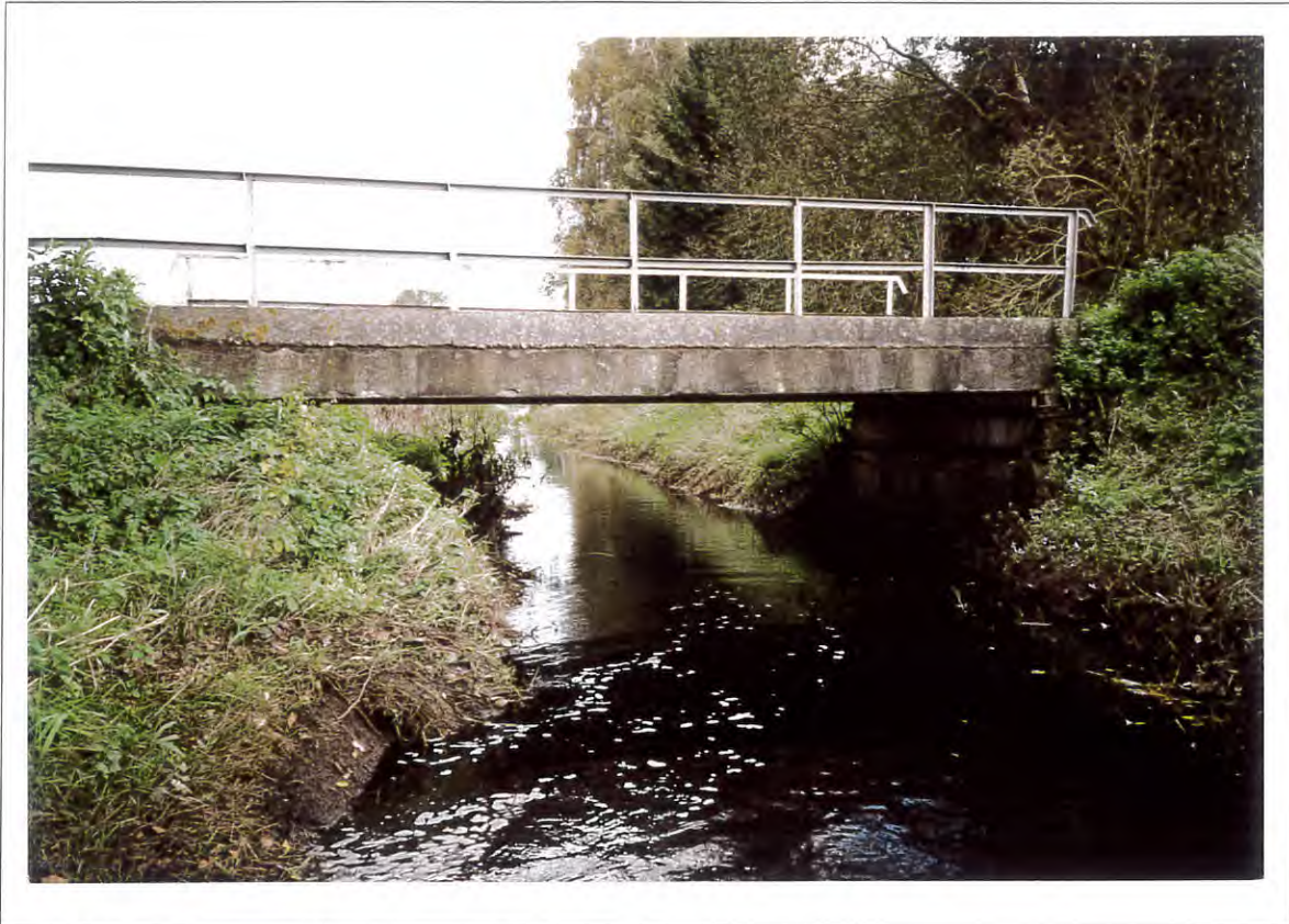
Foto 8: „Moorhäuser Brücke“, Blick in Fließrichtung. Durchlaßbauwerk Nr. 2, Stat. 1 + 850 (geringe Beeinträchtigung !).
