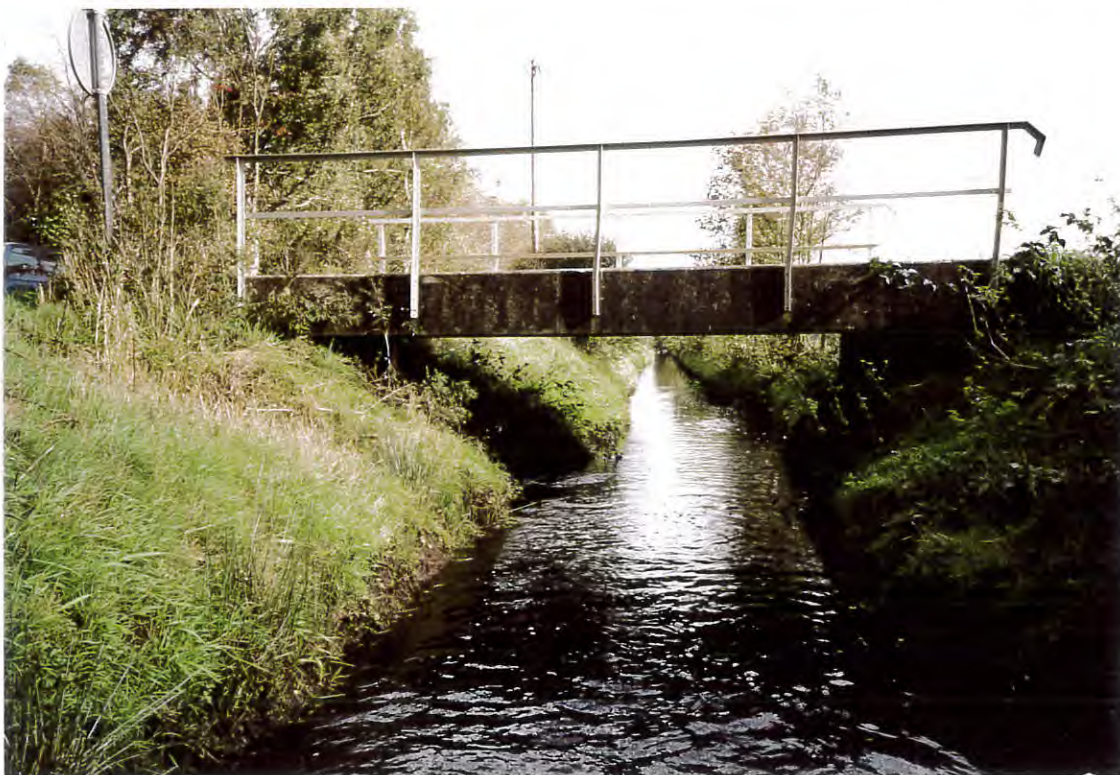
Foto 15: Brücke, Blick in Fließrichtung. Durchlaßbauwerk Nr. 6, Stat. 3 + 435 (geringe Beeinträchtigung !).
