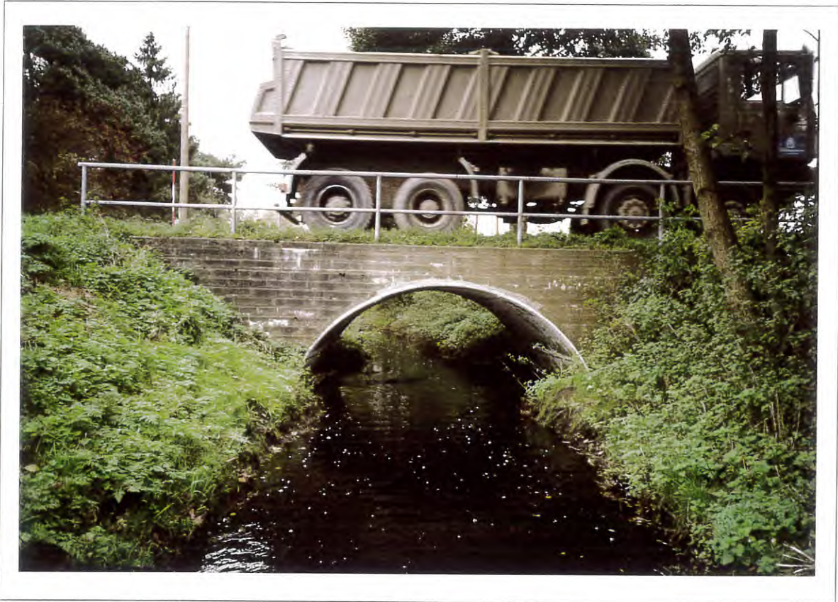
Foto 18: Brücke im Bereich der Zufahrt zur Gewerbefläche (Tierfrischmehlfabrik), Blick in Fließrichtung. Durchlaßbauwerk Nr. 7, Stat. 3+950 (starke Beeinträchtigung !!).
