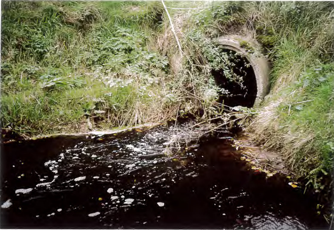
Foto 24: Zufluss des Oberlaufes der Beeke durch einen Rohrdurchlass an der Landkreisgrenze (Stat. 4 + 400), ökologische Durchgängigkeit ist stark eingeschränkt.
