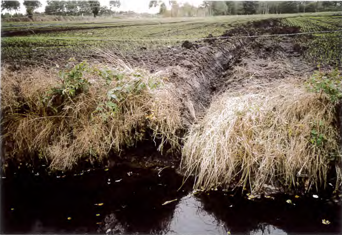
Foto 20: Sedimenteintrag durch künstliche Abflussrinnen von einer Ackerfläche. Räumstreifen ist nicht vorhanden. (Stat. 3+975).
